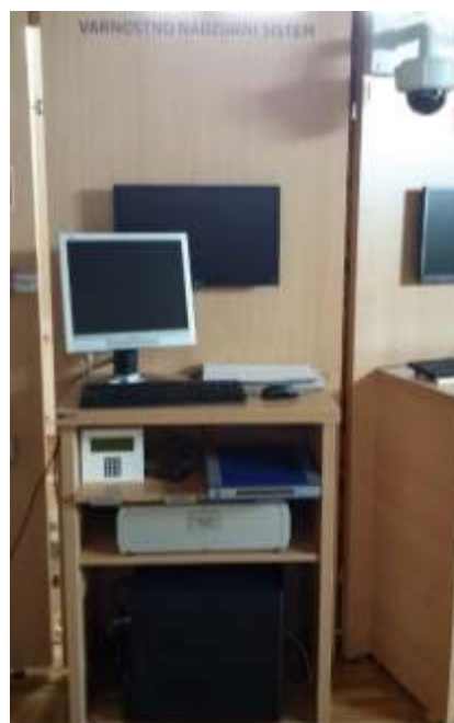
SLIKA 8: Varnostno nadzorni center.
