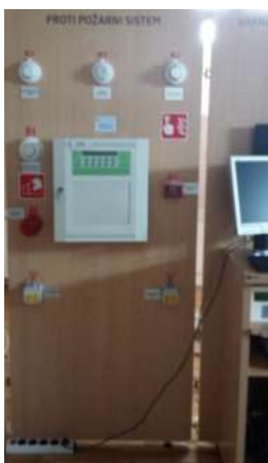
SLIKA 7: Osnovni elementi aktivne požarne zaščite na panoju proti požarnega sistema.
